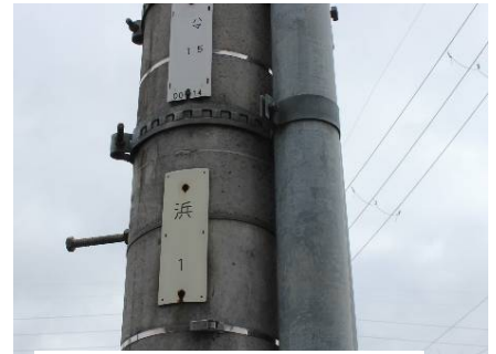
(写真 11) 電柱の表示「浜」
